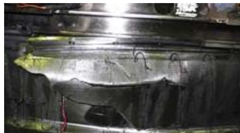
Рис. 9. Корпус вентилятора после испытаний
