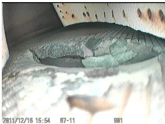
Рис. 1. Внешний вид секторов КР после длительной эксплуатации
